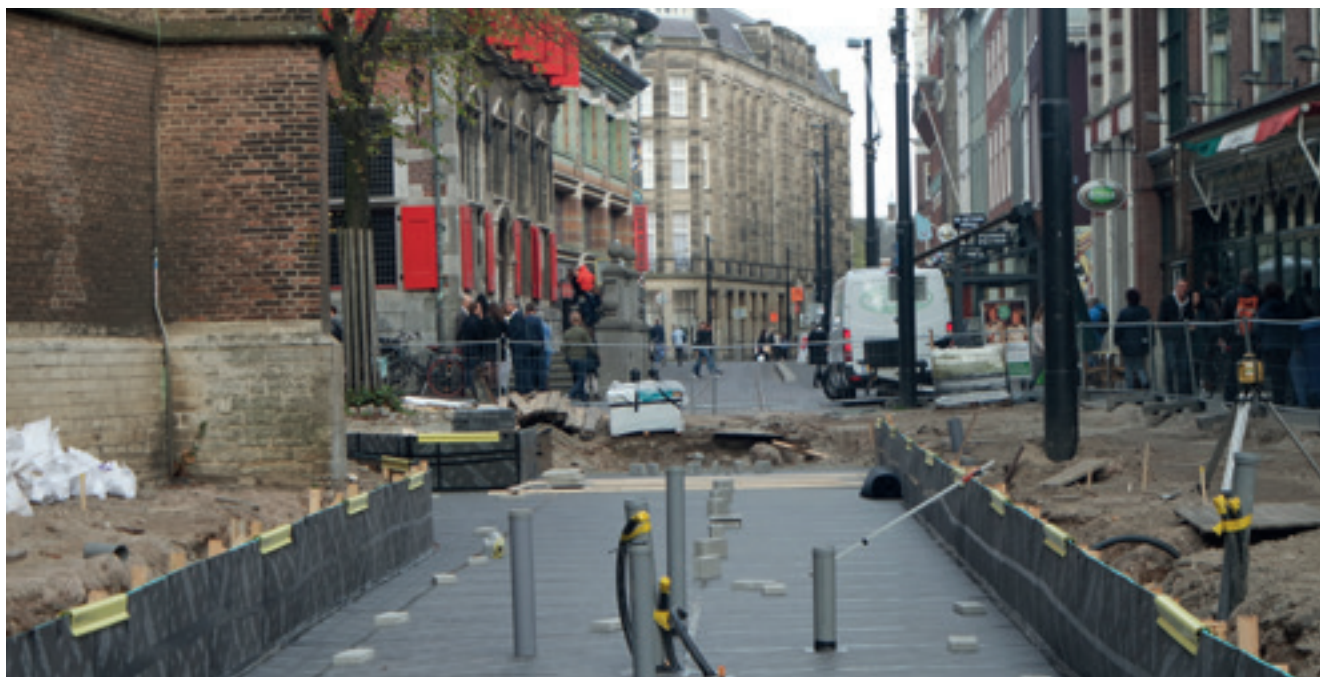
De komst van zwaardere trams verhoogt het risico van schade door trillingen aan de eeuwenoude monumenten. Om dit te beperken wordt bij de Grote Kerk en het Oude Stadhuis een trillingdempend bed onder het tramspoor aangelegd. Opname van 27 oktober 2017. Foto Martin Snuverink.
